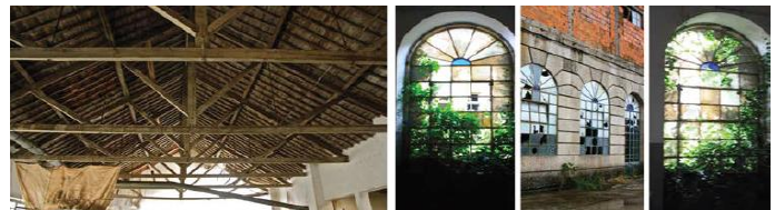
Figura 11: Fábrica Velha. Alguns detalhes internos de cobertura e janelas.
